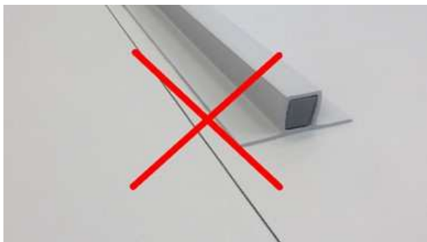
Obr. 19: Vadná instalace – navařený profil umístěný na okraj vrchního pásu hydroizolační fólie nad kotevní řadou
