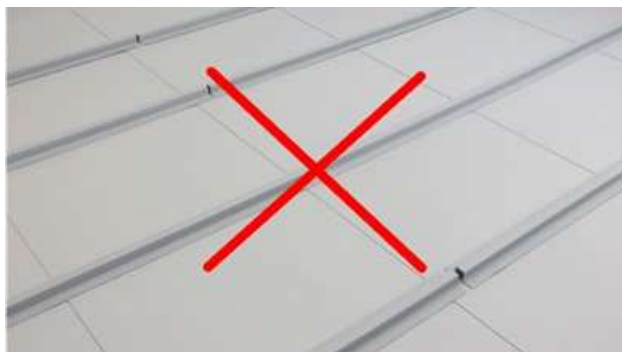
Obr. 17: Vadná instalace – navařené profily umístěné kolmo na spoje pásů hydroizolační fólie
