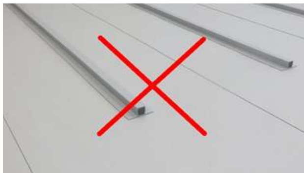
Obr. 18: Vadná instalace – navařené profily umístěné volně středem pásů bez dodatečně vložené kotevní řady
